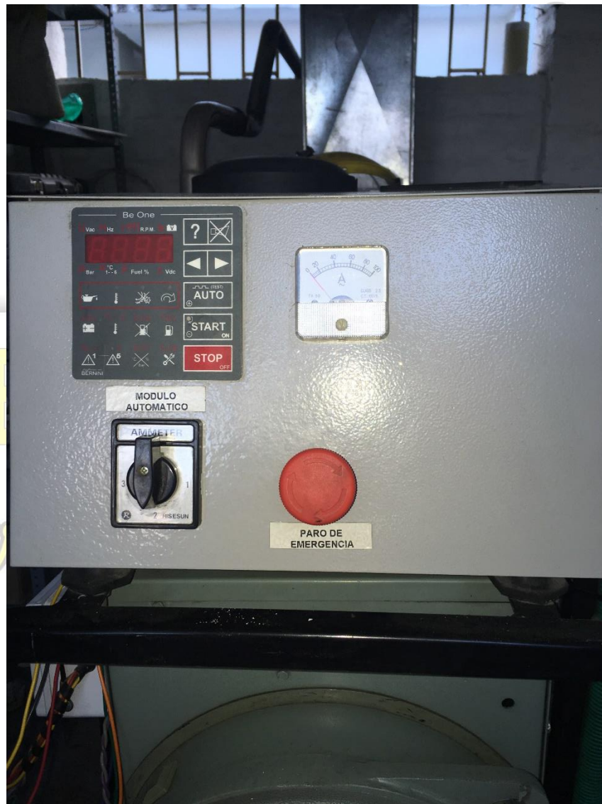
Controlador BE-1 anterior en mal estado
