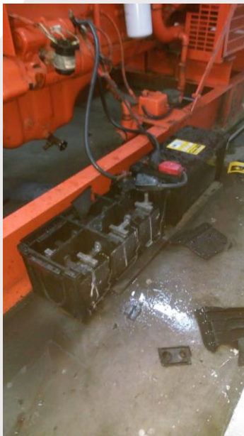
Explosión de acumulador por acumulación de gases, debido a exceso de carga.
